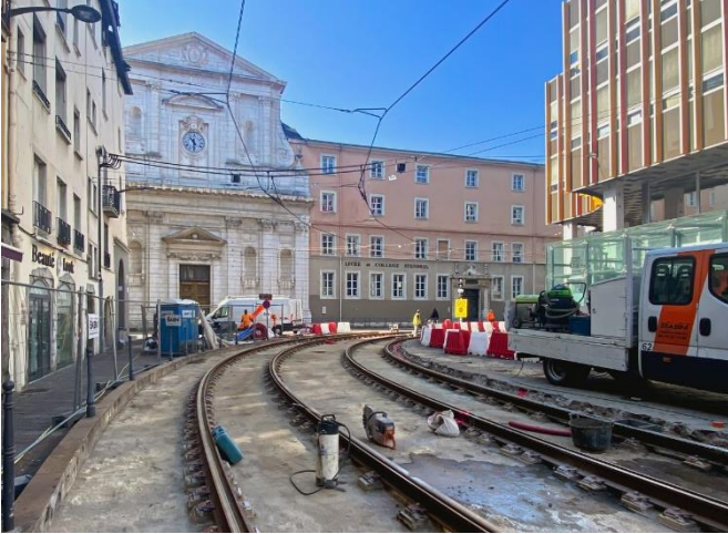
Travaux préventifs et curatifs entre les lignes A et B du tramway de Grenoble
